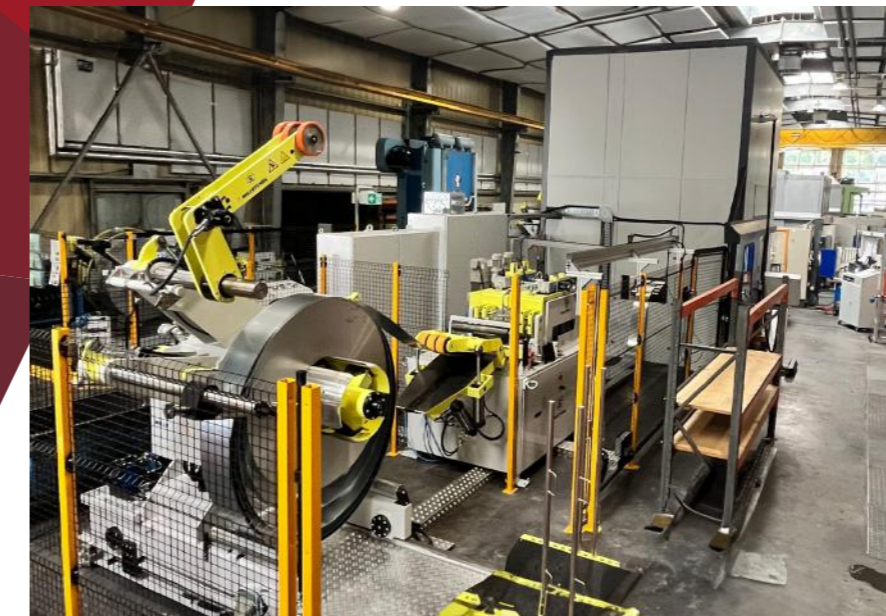
Presselinie Schuler MC125 mit Schalleinhausung
